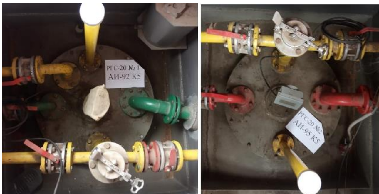
Рисунок 2 – Горловины резервуаров РТС-20 зав.№№ 1, 2
