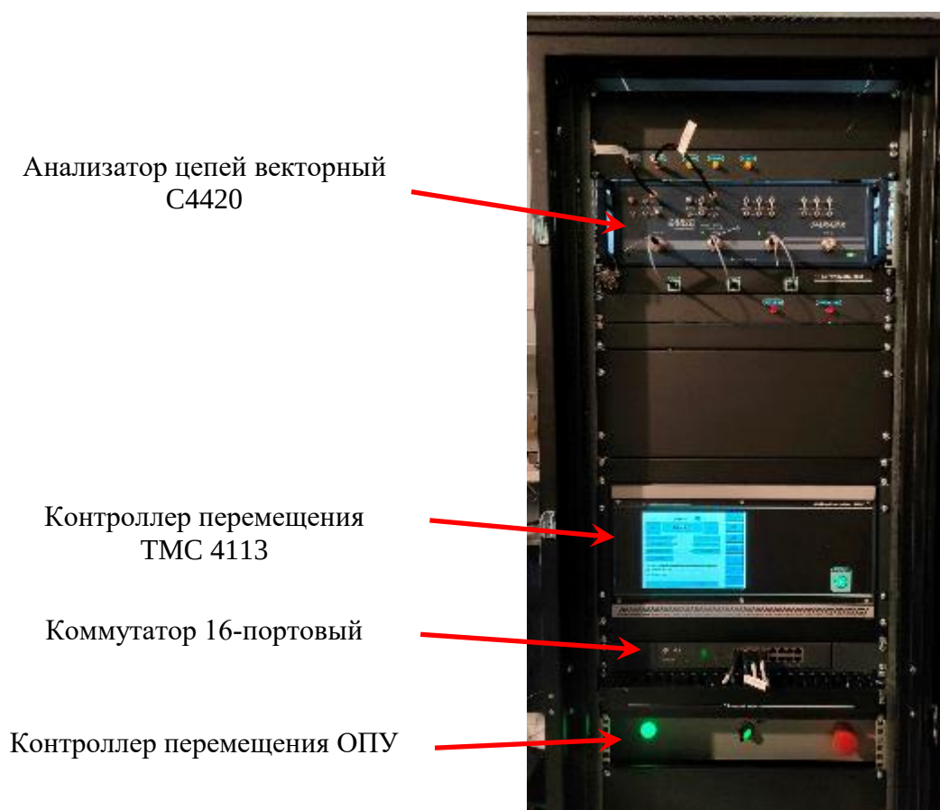
Рисунок 12 – Размещение оборудования в приборной стойке
