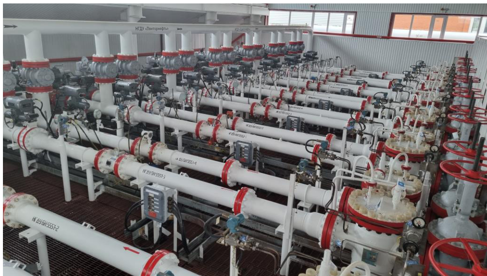
Рисунок 1 – Общий вид СИКН
