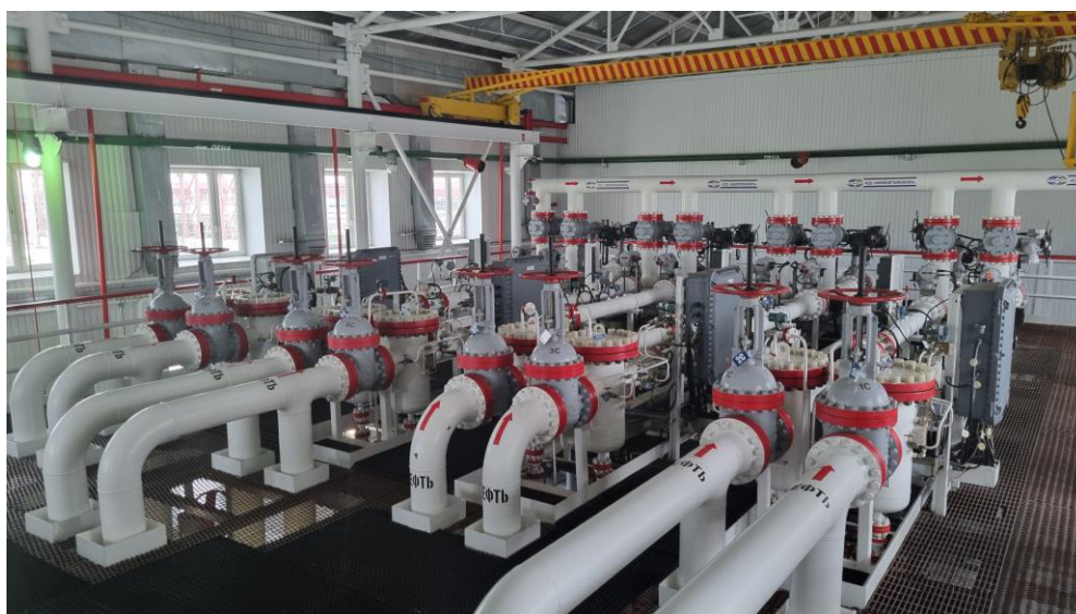
Рисунок 2 – Общий вид СИКН
