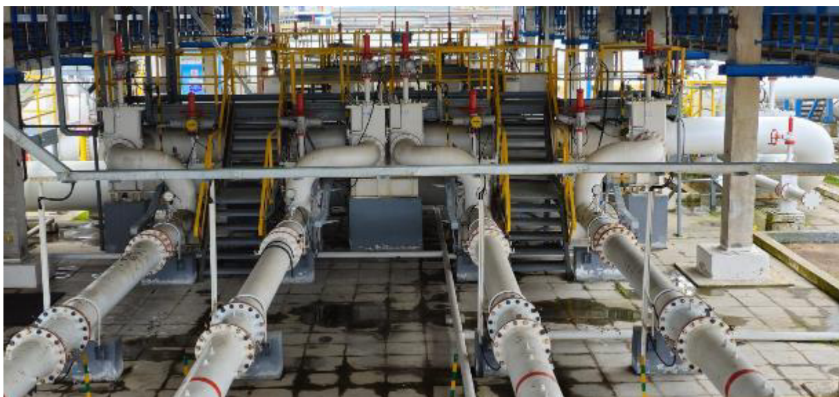
Рисунок 1 – Общий вид СИКН
