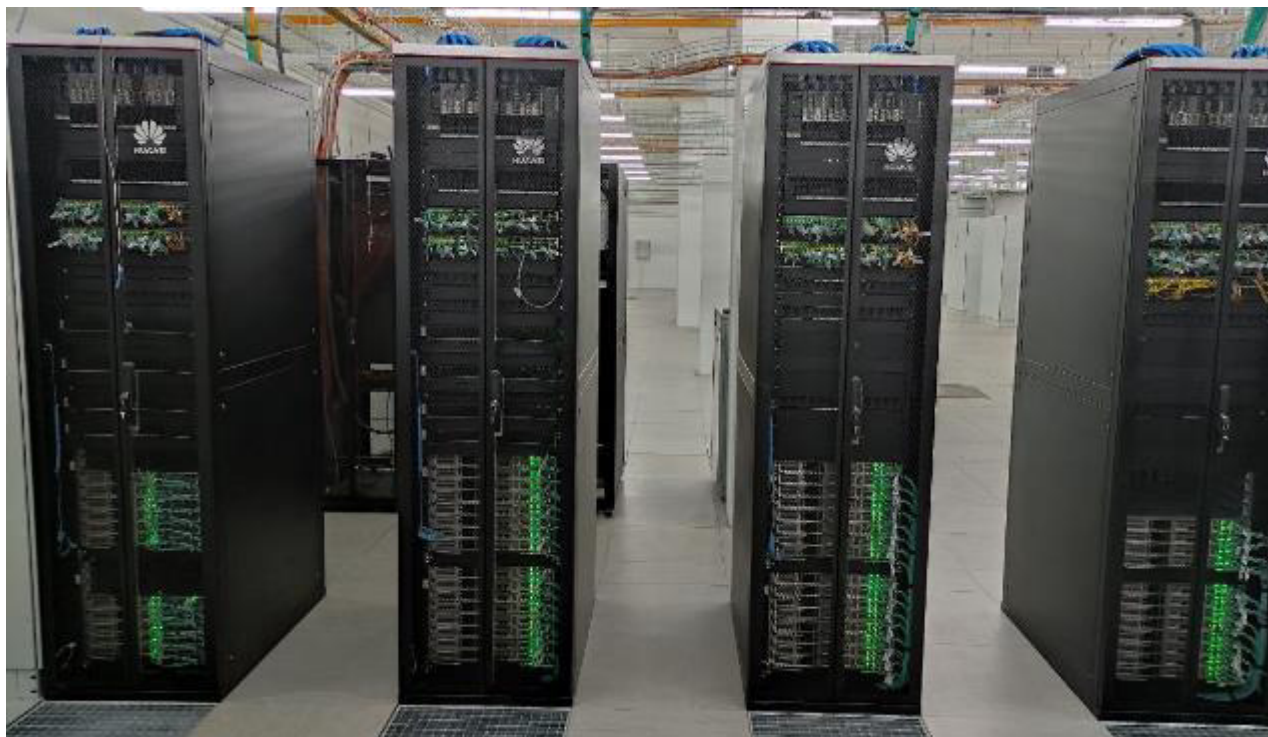
Рисунок 2 – Внешний вид стативов с установленным оборудованием
