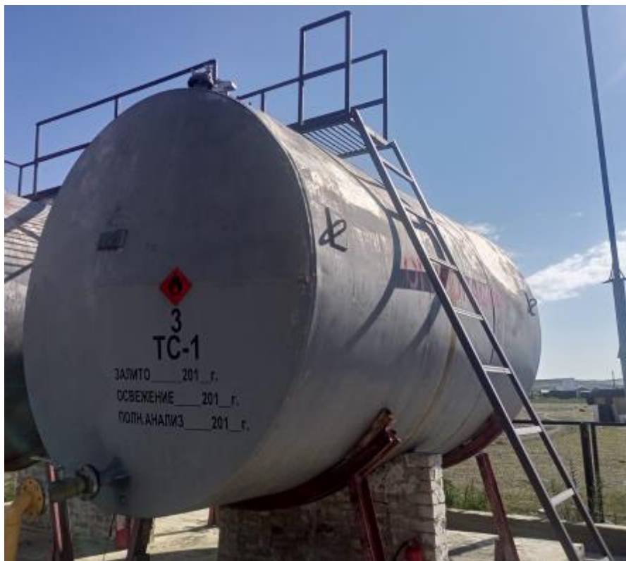
Рисунок 3 – Общий вид резервуара РГС-25 зав.№ 3
