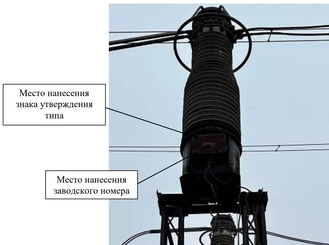
Рисунок 1 – Общий вид трансформатора тока
