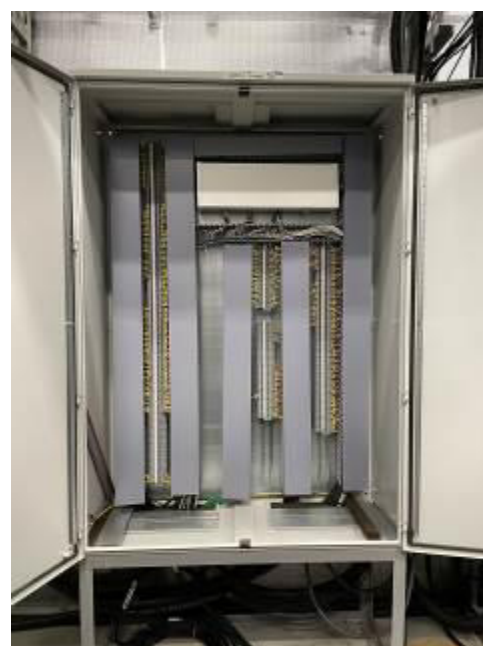
Рисунок 4 – Шкаф кроссового оборудования
