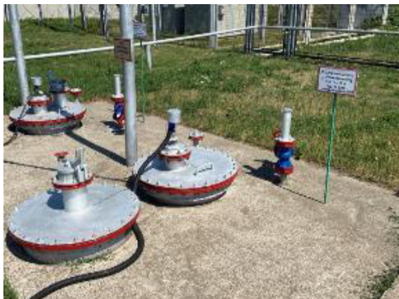
Рисунок 2 – Горловины и замерный люк резервуара
