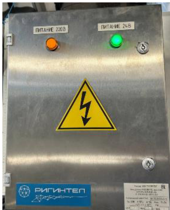
Шкаф управления программно-логическим контроллером (ШУПЛК)
