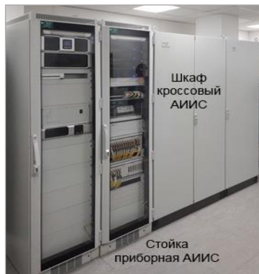
Рисунок 2 – Стойки и шкафы АИИС. Расположение
