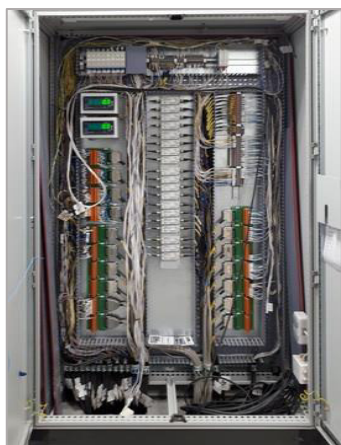
Рисунок 3 – Шкаф кроссовый АИИС. Расположение элементов. Вид внешний
