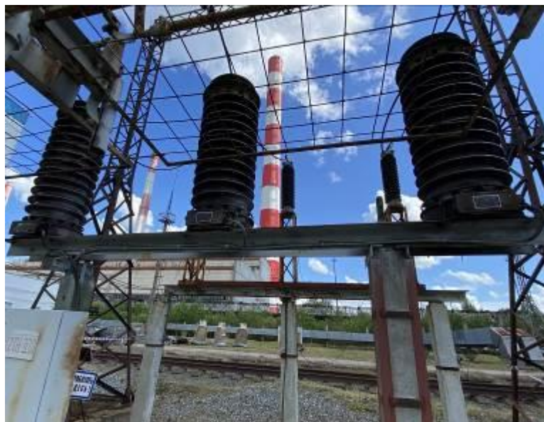
Рисунок 1 – Общий вид трансформаторов напряжения
