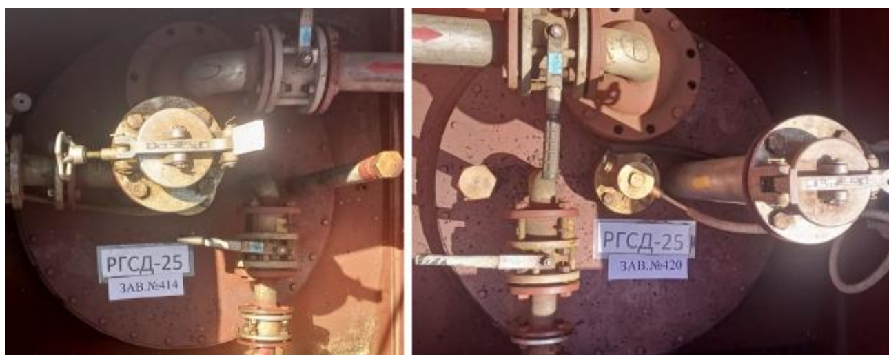
Рисунок 2 – Горловины и измерительные люки резервуаров РГСД-25 зав.№№ 414, 420
