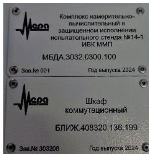
Рисунок 6 – Шкаф коммутационный. Бирка
