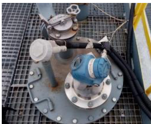
Рисунок 3 – Замерной люк резервуара РГС-20
