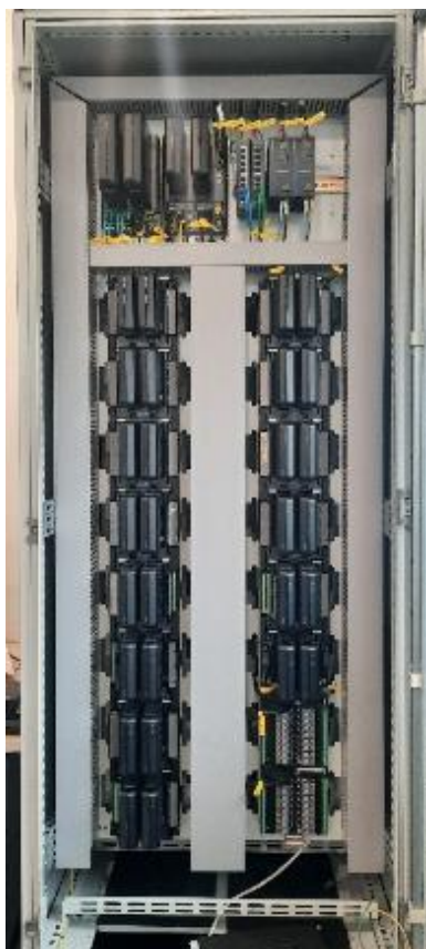
Рисунок 1 – Общий вид стойки модулей ЕРС9600 в электротехническом шкафу
