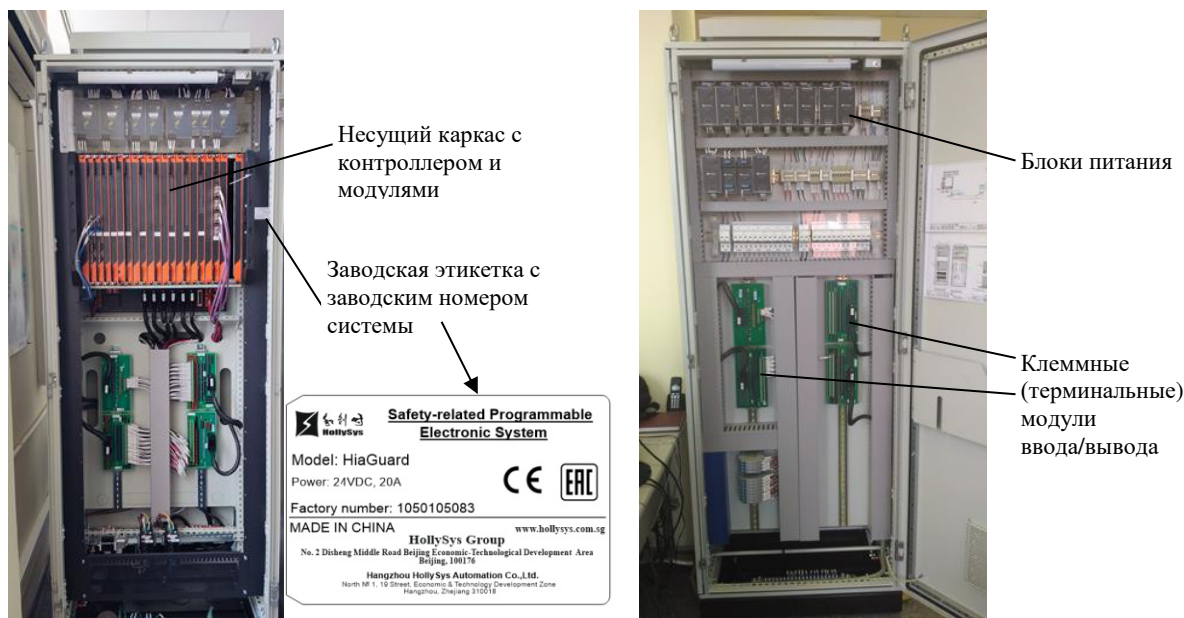
Рисунок 1 – Передняя сторона электротехнического шкафа
