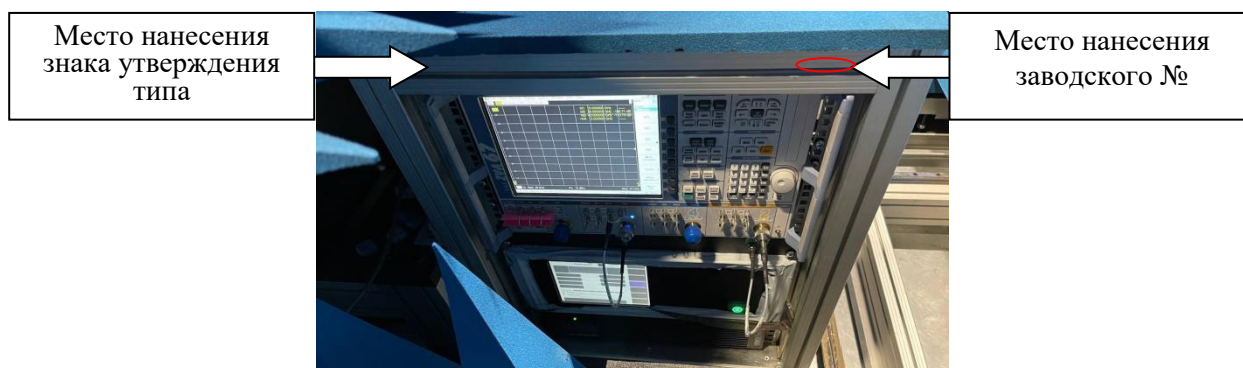
Рисунок 4 – Общий вид приборной стойки с приборами, место размещения наклейки и место нанесения заводского номера
