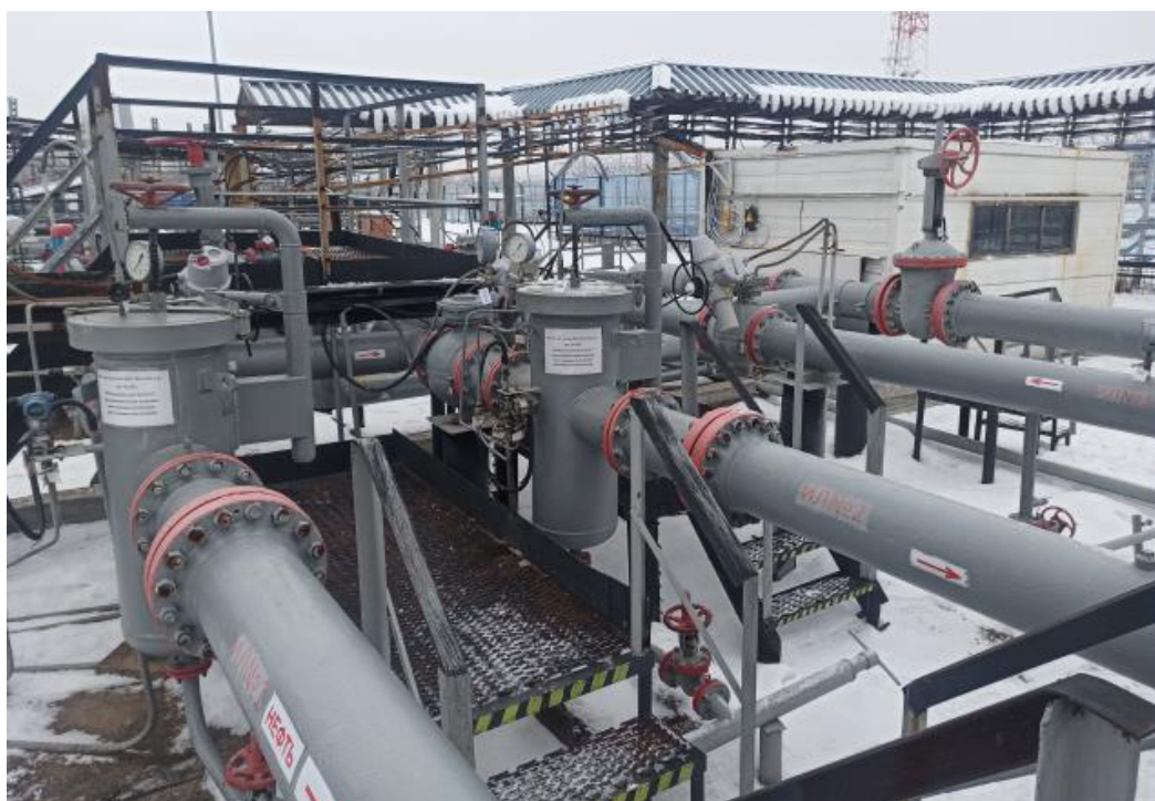
Рисунок 2 – Общий вид СИКН
