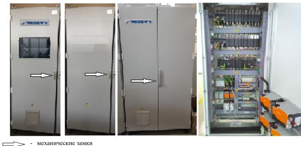
Рисунок 1 – Общий вид шкафа ПТК
