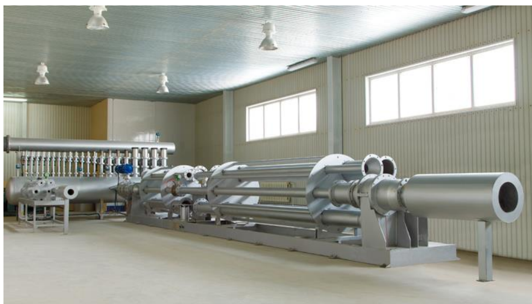
Рисунок 1 - Общий вид установки
