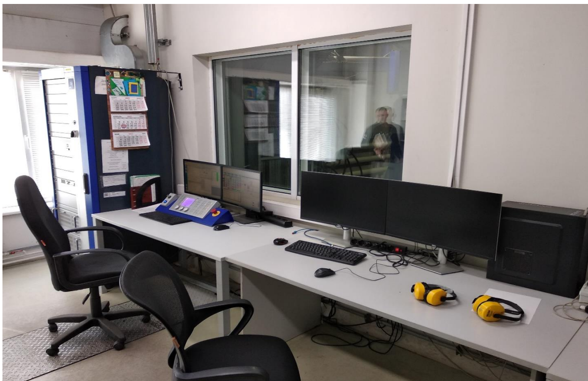
Рисунок 5 – Помещение пультовой, место оператора
