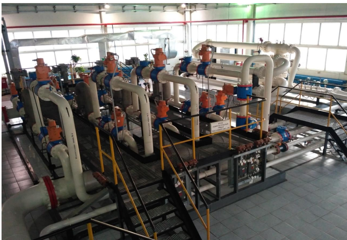
Рисунок 1 – Общий вид СИКН
