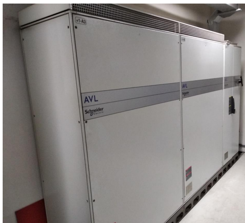
Рисунок 2 – Электрощкаф асинхронной машины DYNOFORCE ASM 5000/1/7-4. Общий вид
