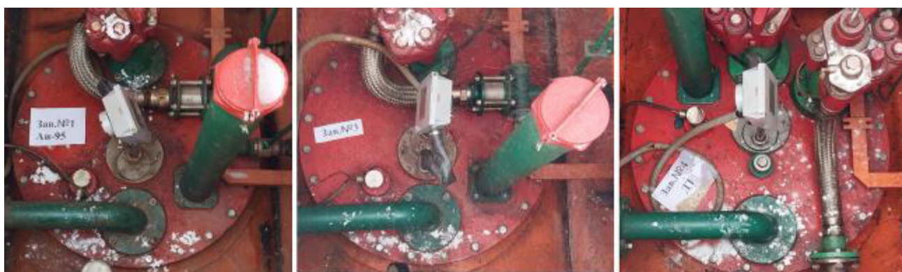
Рисунок 2 – Горловины резервуаров РГС-50 зав.№№ 1, 3, 4
