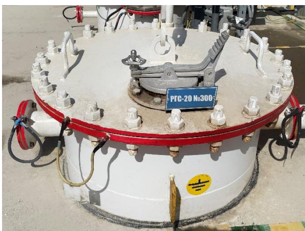
Рисунок 2 – Место нанесения заводского номера резервуара РГС-20
