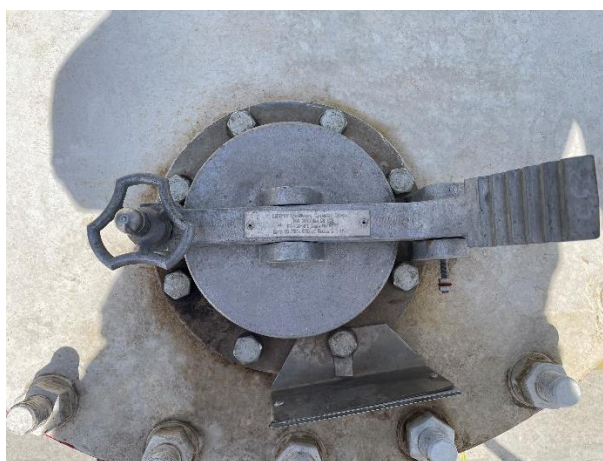
Рисунок 3 – Замерной люк резервуара РГС-20
