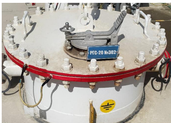
Рисунок 2 – Место нанесения заводского номера резервуара РГС-20
