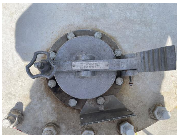
Рисунок 3 – Замерной люк резервуара РГС-20
