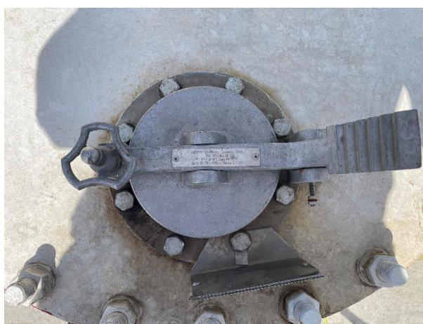
Рисунок 3 – Замерной люк резервуара РГС-20
