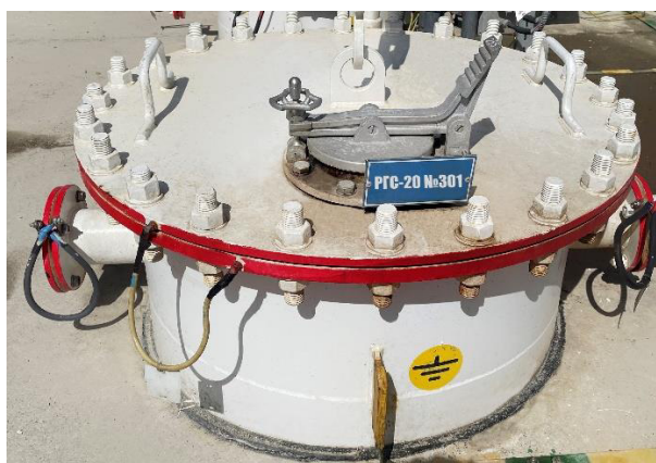
Рисунок 2 – Место нанесения заводского номера резервуара РГС-20
