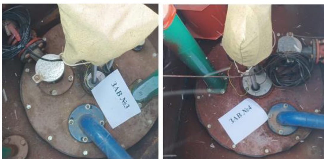
Рисунок 3 – Горловины резервуаров РГС-25 зав.№№ 3, 4
