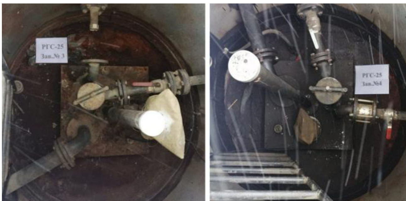
Рисунок 3 – Горловины резервуаров РГС-25 зав.№№ 3, 4
