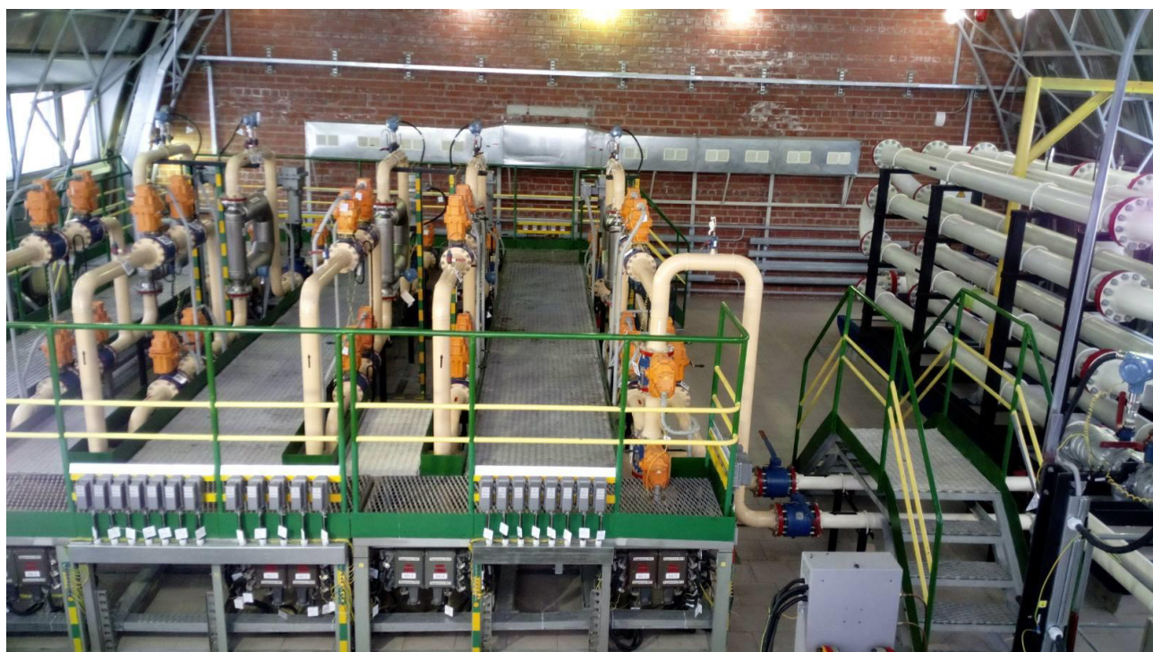
Рисунок 1 – Общий вид СИКН
