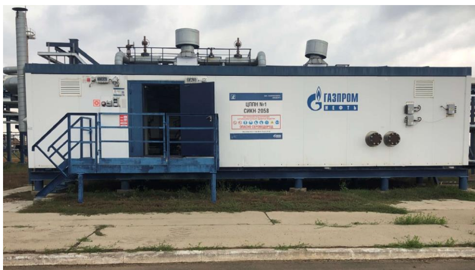
Рисунок 1 – Общий вид СИКН
