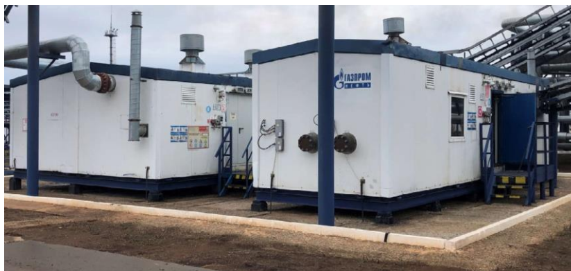
Рисунок 1 – Общий вид СИКН
