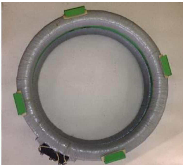
Рисунок 1 – Общий вид трансформатора
