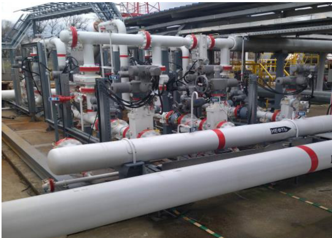
Рисунок 1 – Общий вид СИКН
