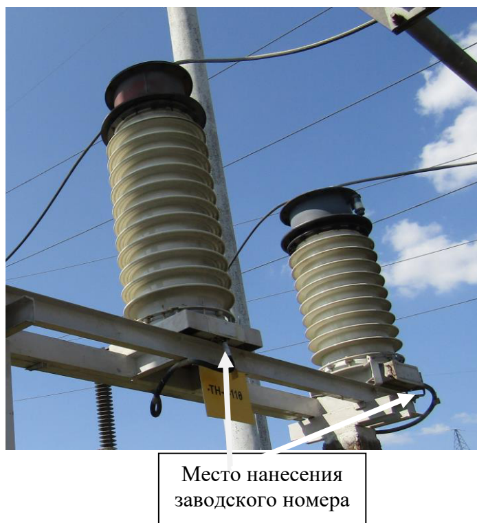
Рисунок 1 - Общий вид трансформаторов напряжения НКФ-110-57 У1
