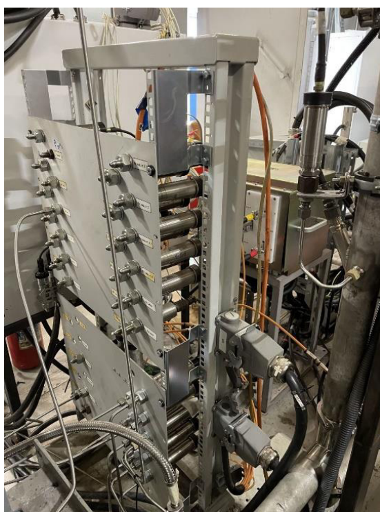
Рисунок 5 – Стойка датчиков давления
