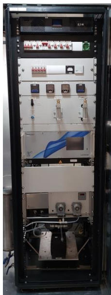
Рисунок 1 – Общий вид шкафа с газоанализатором марки ProCeas
