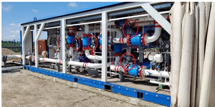
Рисунок 1 - Общий вид СИКН
