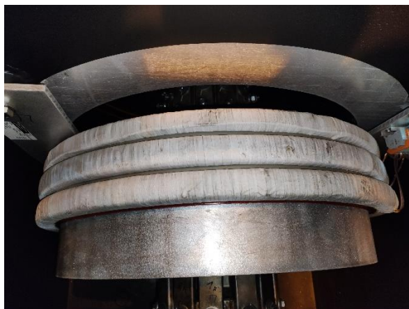
Рисунок 1 – Внешний вид трансформаторов
