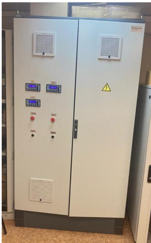
Рисунок 1 – Шкаф с оборудованием Комплекса
