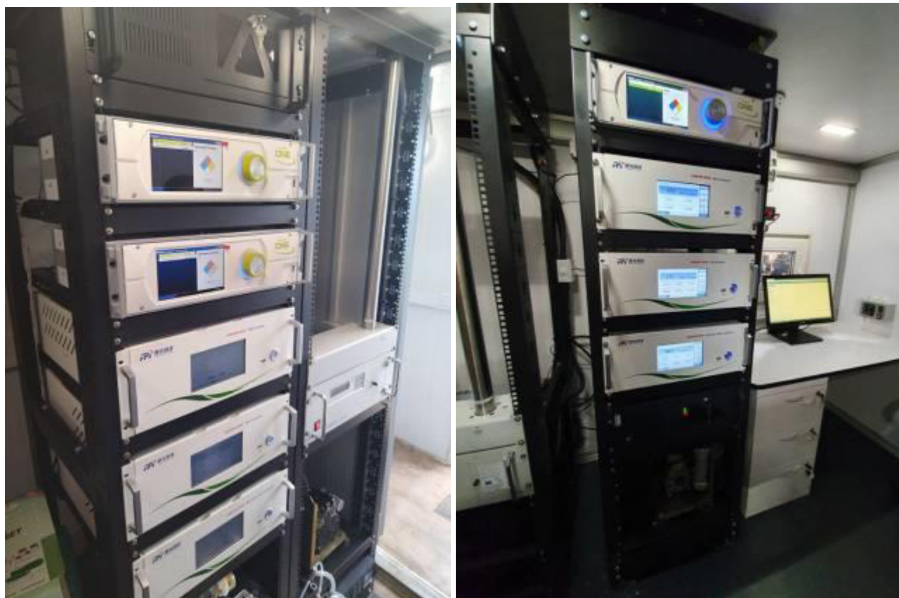
Рисунок 2 – Вид станции изнутри (стойка с приборами)
