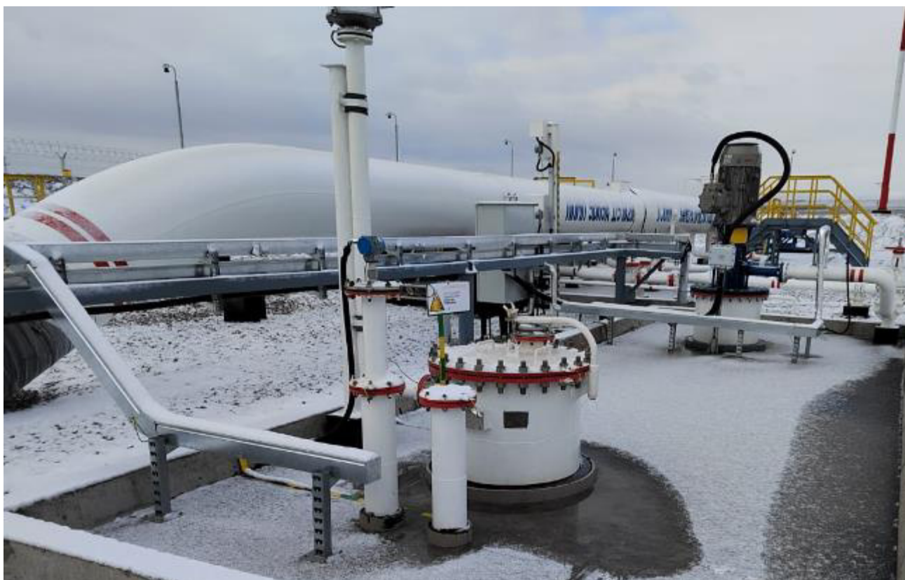
Рисунок 3 – Горловины и измерительный люк резервуара ЕП-40-550-А-СО-У1 зав.№ 59346
