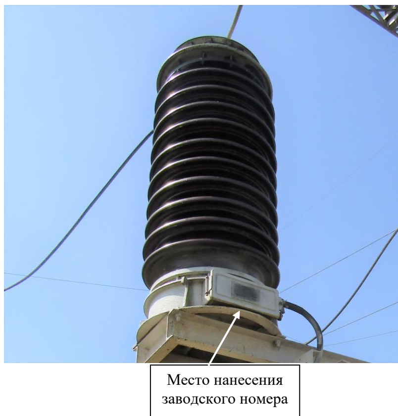
Рисунок 1 - Общий вид трансформатора напряжения НКФ-110-58
