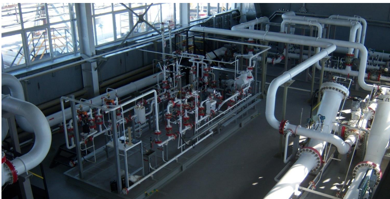
Рисунок 1 – Общий вид СИКН
