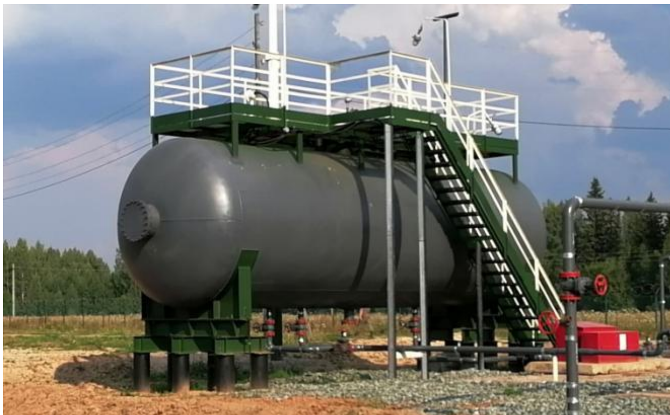
Рисунок 1 - Общий вид резервуара горизонтального стального цилиндрического РГС-85
