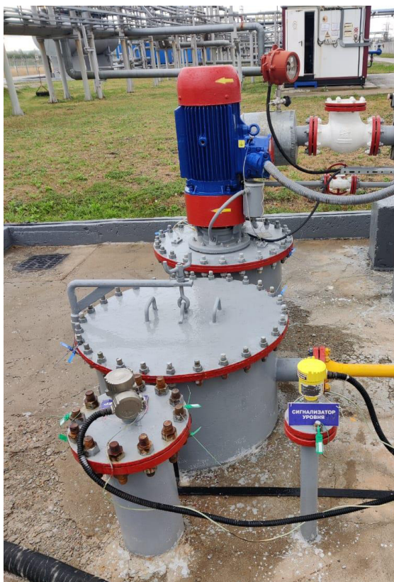
Рисунок 2 – Горловины и замерный люк резервуара.
