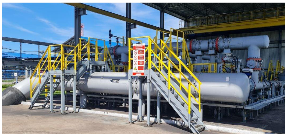
Рисунок 1 - Общий вид СИКН
