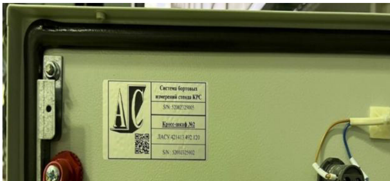
Рисунок 6 - Тыльная сторона дверцы кросс-шкафа 2 с заводским знаком
