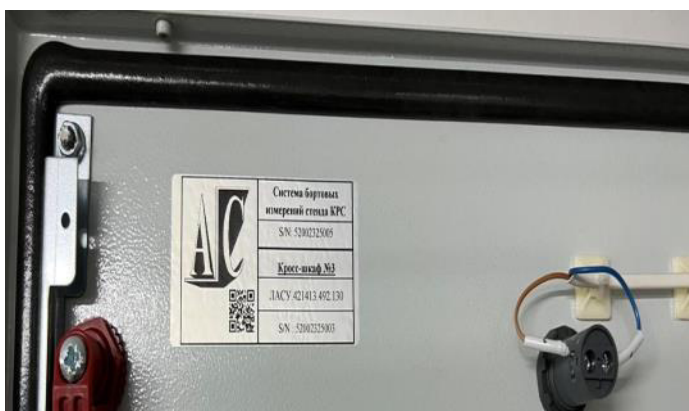
Рисунок 8 - Тыльная сторона дверцы кросс-шкафа 3 с заводским знаком
