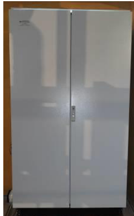
Рисунок 4 – Шкаф СУ. Общий вид
