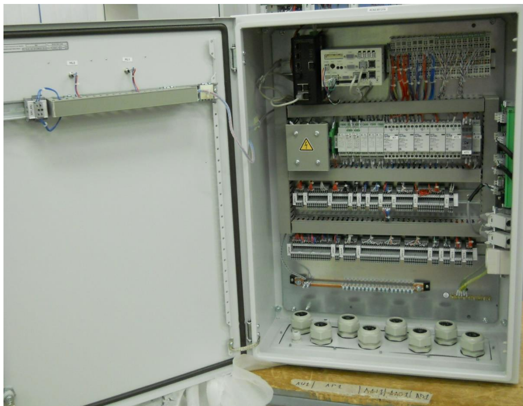
Рисунок 1 – Общий вид шкафа автоматики комплекса
