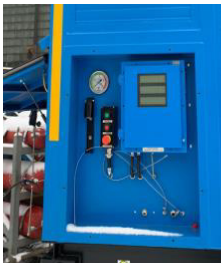
в составе модуля компримирования природного газа
