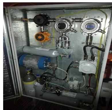
Рисунок 8 – Общий вид внутри шкафа системы
