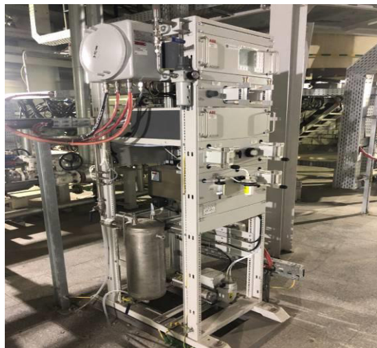
Рисунок 5 – Общий вид шкафа
