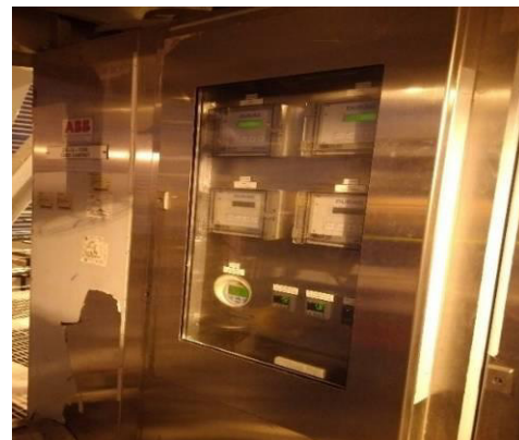
Рисунок 4 – Общий вид внутри шкафа системы
