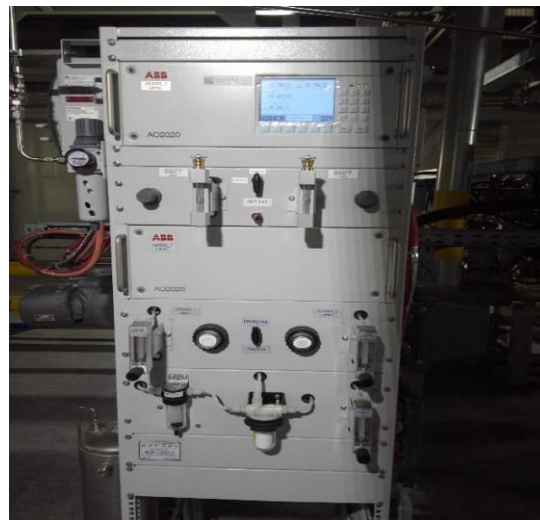
Рисунок 6 – Общий вид внутри шкафа системы
