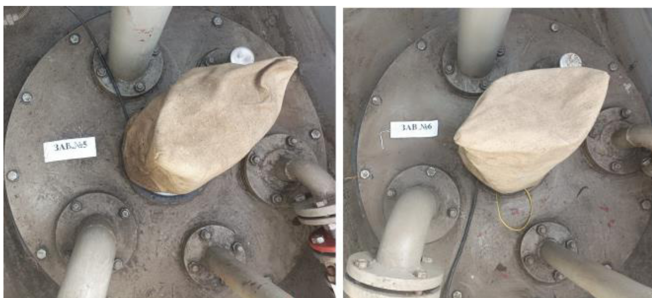
Рисунок 4 – Горловины резервуаров РГС-25 зав.№№ 5, 6
