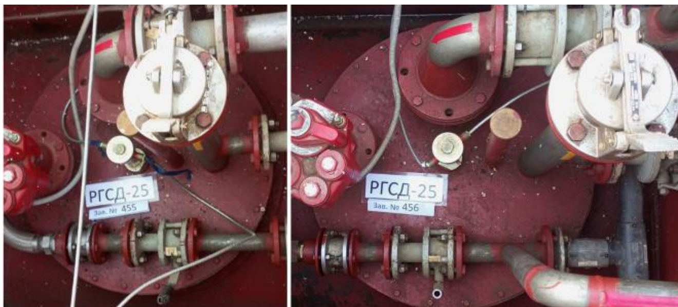
Рисунок 2 – Горловины и измерительные люки резервуаров РГСД-25 зав.№№ 455, 456
