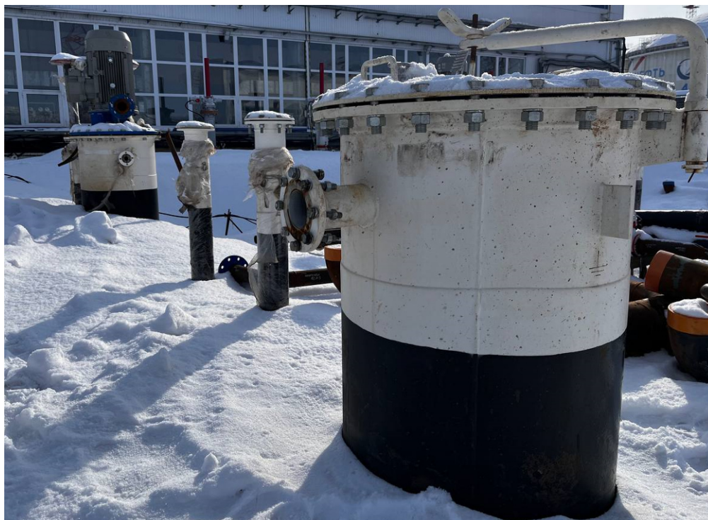
Рисунок 3 – Горловины и измерительный люк резервуара ЕП-40-2400-1500-А-СО-У1 зав.№ 6954
