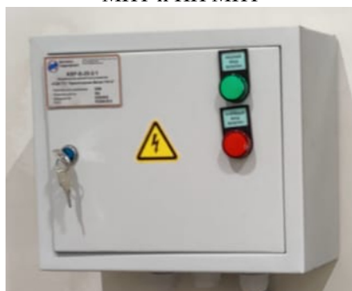
Щит управления вычислительного комплекса и бесперебойного питания
