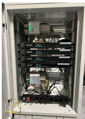
Шкаф вычислительного комплекса
